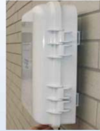
باکس نصب شده روی دیوار
