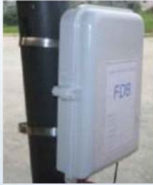
باکس نصب شده روی تیر
